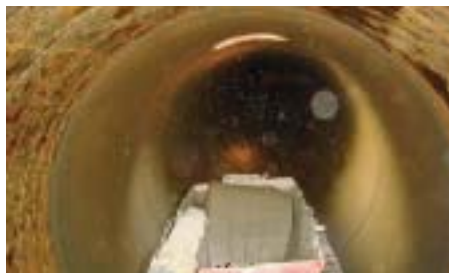
FIGURA 6 - UNA RIPRESA DALL'INTERNO DI UNA TUBAZIONE PRATICABILE DURANTE L'APPLICAZIONE DEL RIVESTIMENTO IN MALTA CEMENTIZIA
